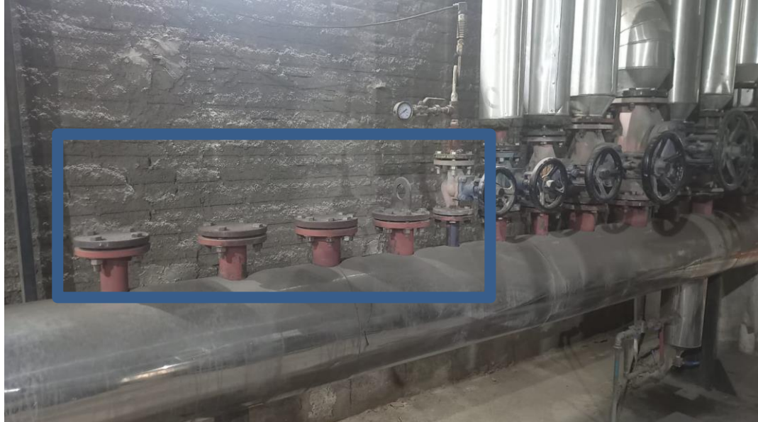
Esperas existentes de vapor:
