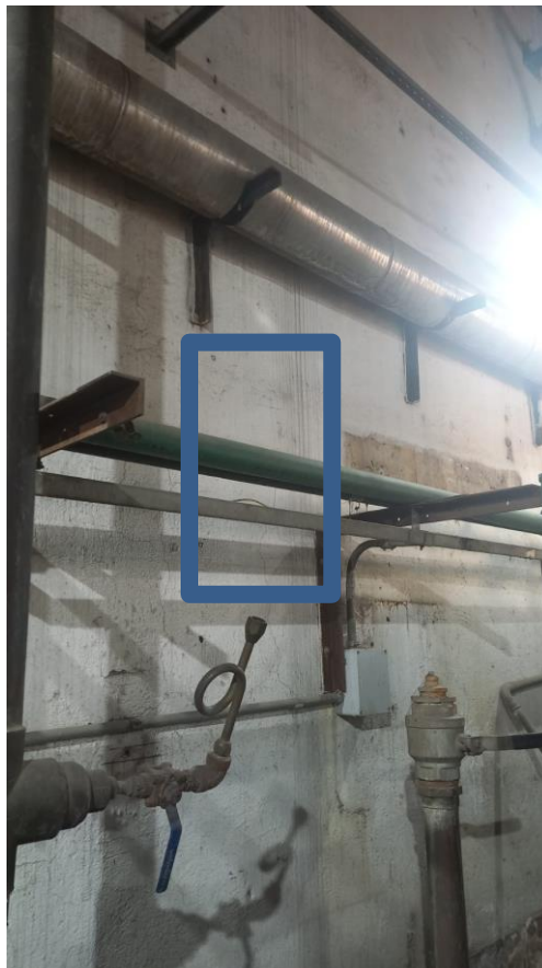
Local de Interligação com a Água quente:
